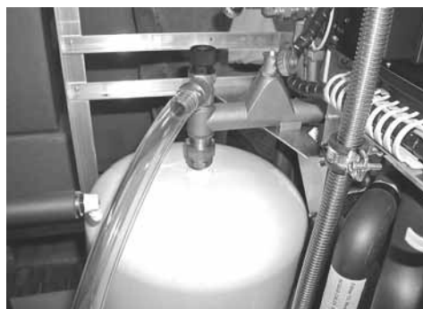
Reservatório de expansão e conduta de saída de ar
