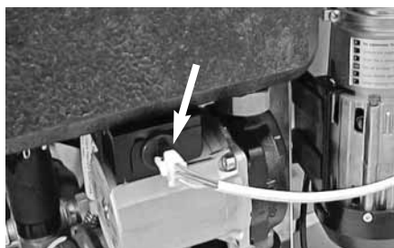
Bomba de água quente
