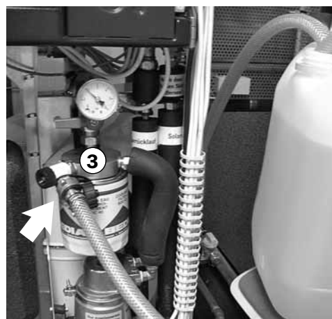
Mangueira de abastecimento ligada na torneira de abastecimento
