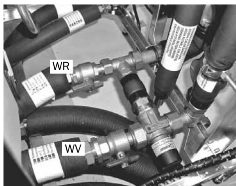
Tubagem de água quente
