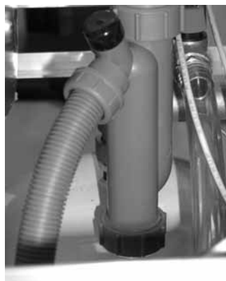
Sifão e tubo de condensado
